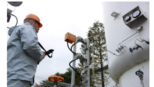
▲敷地内エネルギー管理
